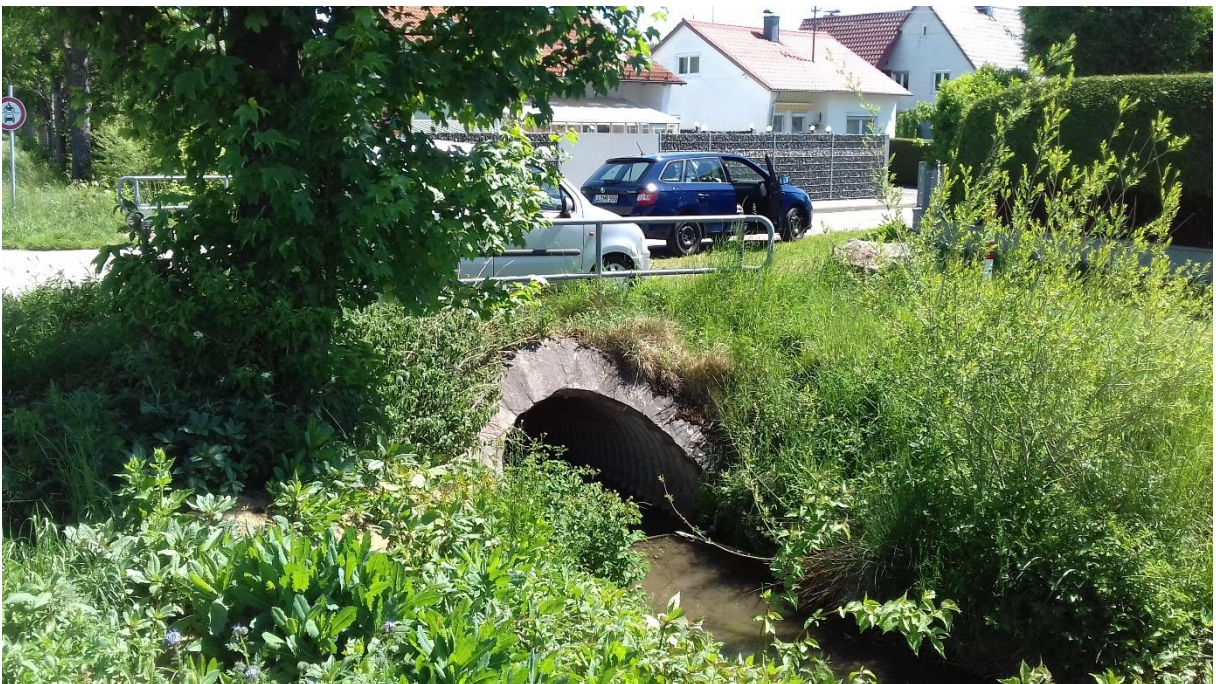
Abbildung 6: Wellstahldurchlass an der Roth Prielweg Oberstrom
